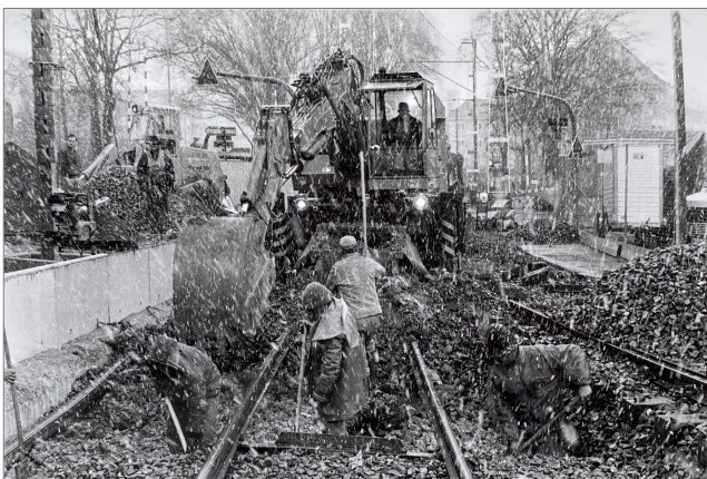
Travaux d'entretien dans le Sihltal dans les années 1990 dans des conditions météorologiques difficiles
